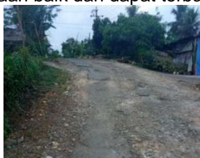
Gambar 3. Kondisi Jalan Sumber : Data Primer, 2022
